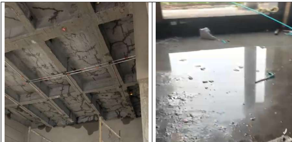
Filtraciones evidenciadas al iniciar la época invernal.
