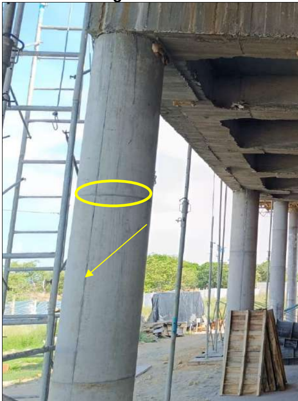
Se evidencia marcada en la columna la unión de los cuerpos de formaleta.
