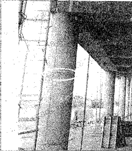
Se evidencia marcada en la columna la unión de los cuerpos de formaleta.
