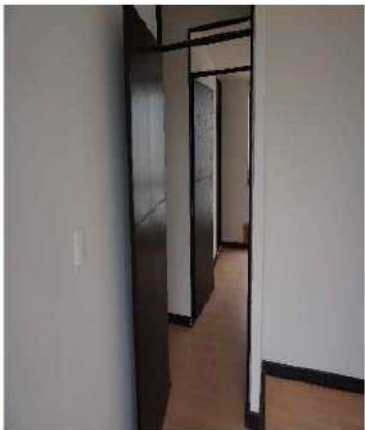
Comentarios: Vista interna de apartamento localizado en el bloque 8 torre G, donde se observa que está pendiente la instalación de chapas de seguridad para puertas.
