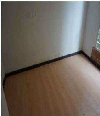
Comentarios: Vista de área de habitación apartamento 1 pisos bloque 6 Torre G, el cual presenta problemas de humedades sobre el muro.
