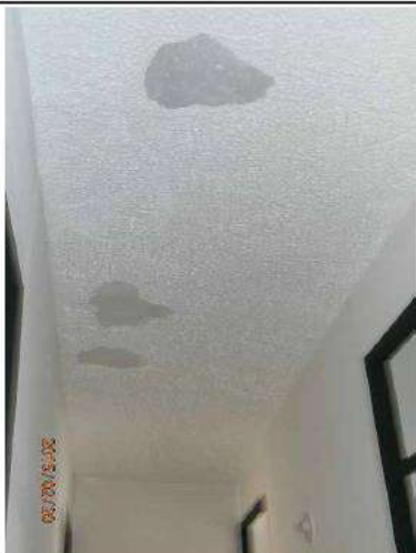
Comentarios: Cielo raso de vivienda de 5 piso en Torre G3, con presencia de humedad, se requiere ajuste
