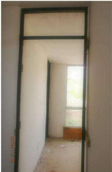
Comentarios: Vanos de puertas desplomados, se evidencia variaciones en la dilatación.
