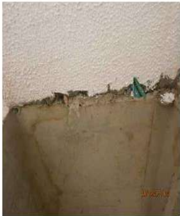
Comentarios: Carencia de recubrimiento de las instalaciones y refuerzo entre placa de entrepiso.
