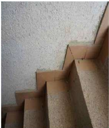
Comentarios: Vista del área de punto fijo de los bloques 7 y 8 torre G, donde se observa que a la fecha no se ha realizado el llenado de juntas en la tableta de piso y guarda escoba instalado.
