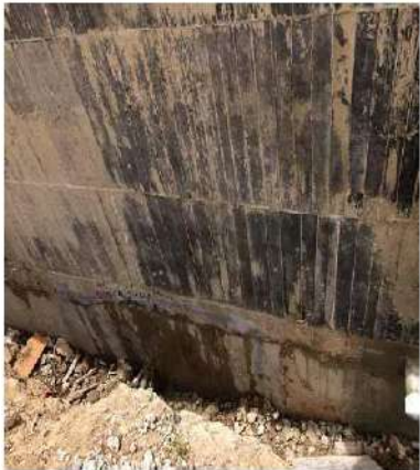
Comentarios: Tanque de almacenamiento costado occidental en proceso de prueba de estanqueidad, con presencia de fugas.
