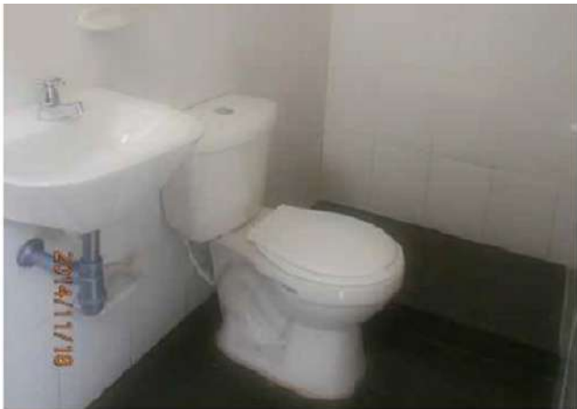
Comentarios: Baño de alcoba principal de Torre G bloque 1, donde se presentan fugas.
