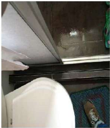
Comentarios: Alteraciones en la ubicación del elemento de separación del baño, la cual requiere adecuaciones inadecuadas de división de baño.
