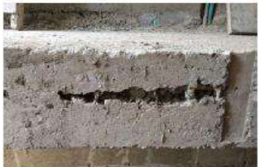
Comentarios: Segregaciones significativas con refuerzo expuesto en remate de placas entrepiso
