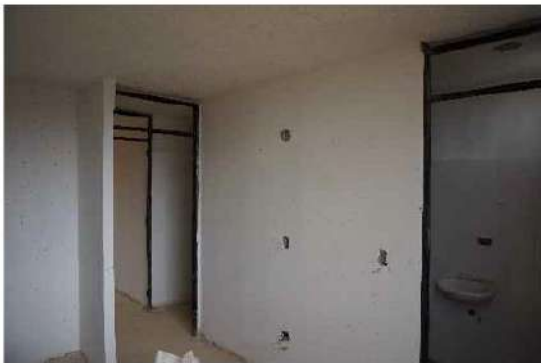
Comentarios: Vista interna del área de habitación del apartamento 101 del bloque 1 Torre F, en actividades de instalaciones y acabados, donde se evidencia que los marcos metálicos instalados para las puertas no quedaron a la medida del espacio o vano.
