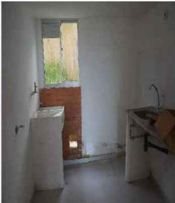
Comentarios: Vista de apartamento 1 piso bloque 6 Torre G, área de cocina, donde se observa detalle de humedad sobre el muro a mejorar, pendiente instalación de rejilla plástica de ventilación y llave de suministro de agua para lavadero.
