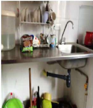
Comentarios: Desagüe de lavaplatos en contrapendiente, en vivienda de la Torre G Bloque 1 (entregado a beneficiario).
