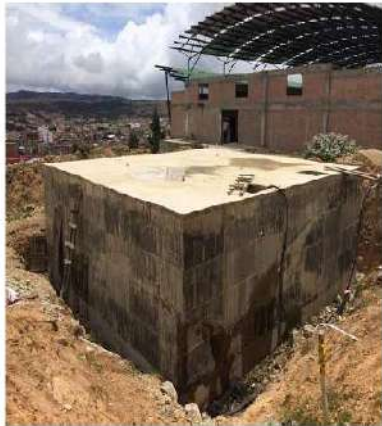
Comentarios: Tanque de almacenamiento costado oriental en proceso de prueba de estanqueidad, con presencia de fugas.
