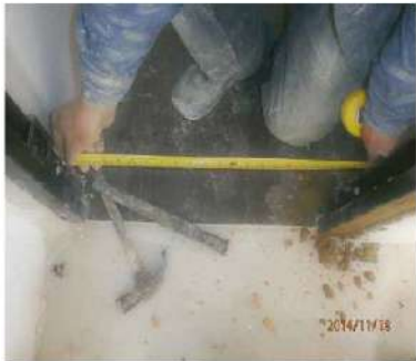
Comentarios: Dimensiones reducidas en puertas internas de baños.
