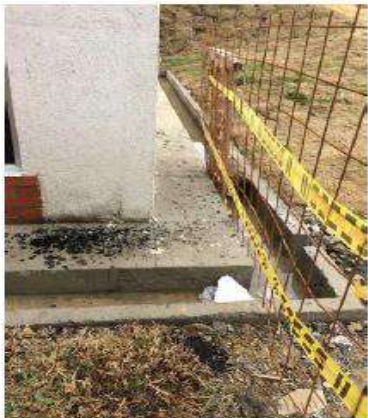
Comentarios: Contrapendientes en los desagües de canales exteriores de Torre G bloque 3.
