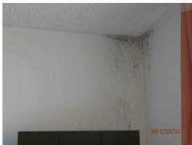
Comentarios: Presencia de humedades en 3 piso de Torre G2 a borde de dilatación constructiva
