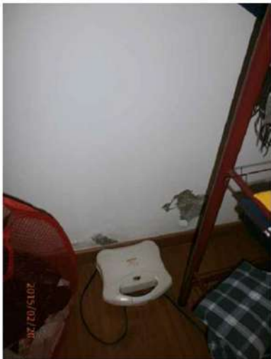
Comentarios: Presencia de humedades en 1 piso de Torre G3, causada principalmente por el agua de escurrientia.
