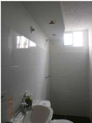
Comentarios: Afectación del drywall en baño auxiliar, causado posiblemente por fugas de instalaciones hidráulicas.
