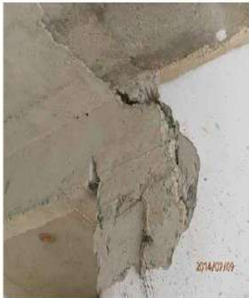
Comentarios: Malformación en remate de muro, refuerzos expuestos
